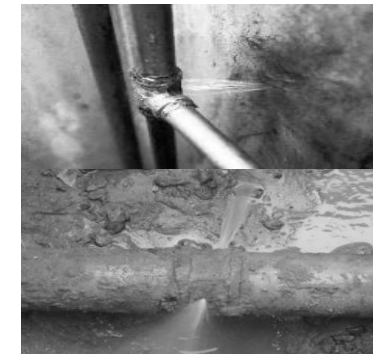
Canalisation d' Alimentation en eau
