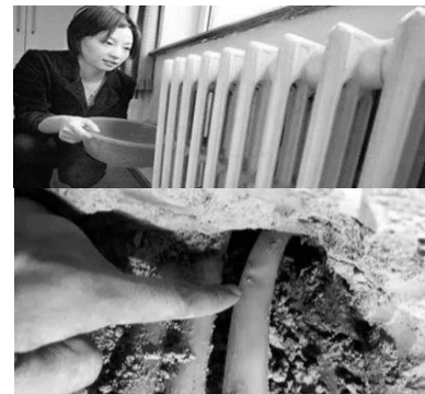
Fuite sur chauffage au sol ou tuyauterie de chauffage
